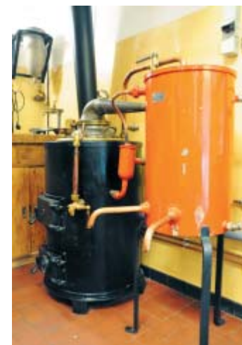
Altes Schätzchen: Die Anlage ist seit einem Jahr verplombt, wird aber schon seit zehn Jahren nicht mehr genutzt. Früher ist der Brenner mit Holz beheizt worden.
